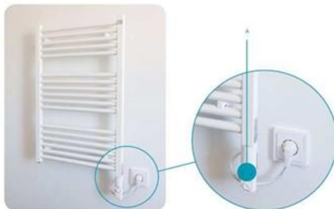
Foto: overzicht bediening radiator badkamer
