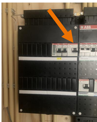
Foto: aparte aardlekschakelaar voor de zonnepanelen
