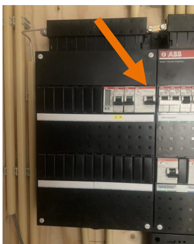
Foto: aparte aardlekschakelaar voor de zonnepanelen
