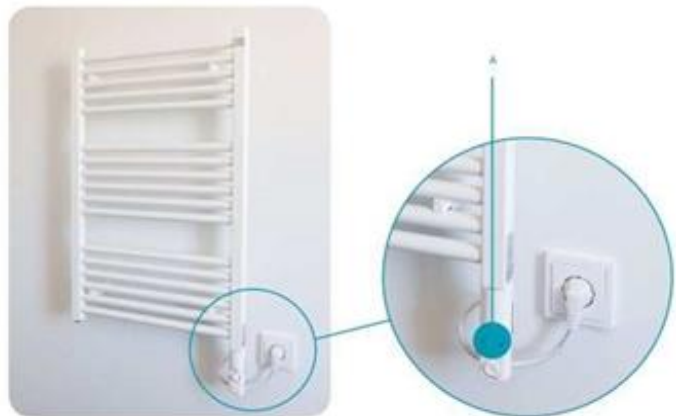
Foto: overzicht bediening radiator badkamer
