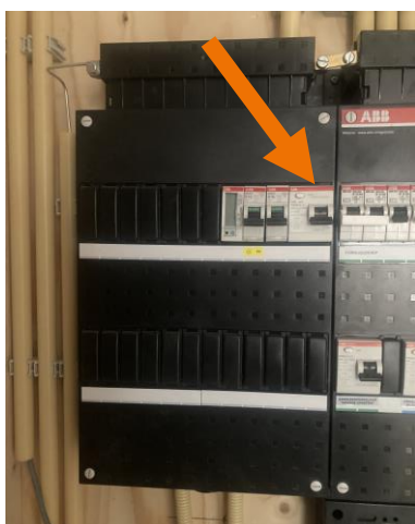
Foto: aparte aardlekschakelaar voor de zonnepanelen
