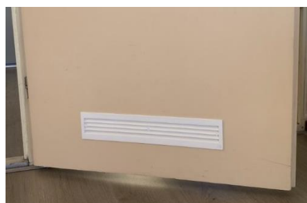
Ventilatierooster in een binnendeur
